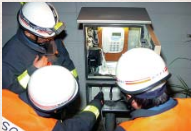
トンネル内の消防用無線接続装置を使った訓練
